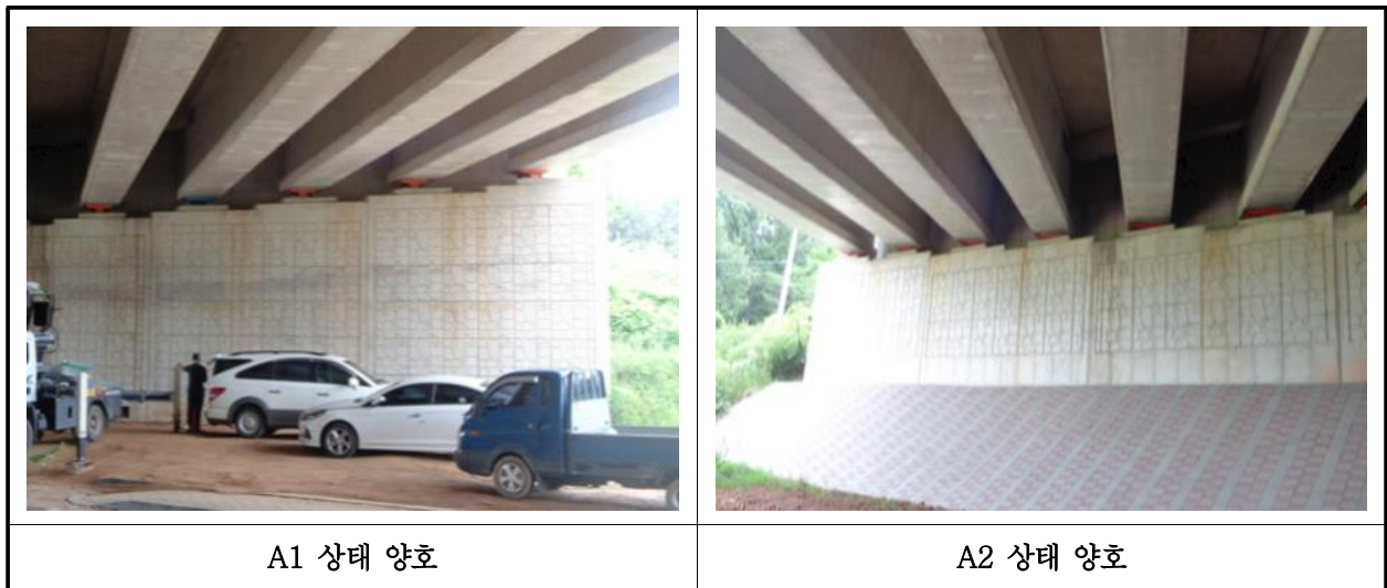
【사진 14.3.9】 교대 손상현황
